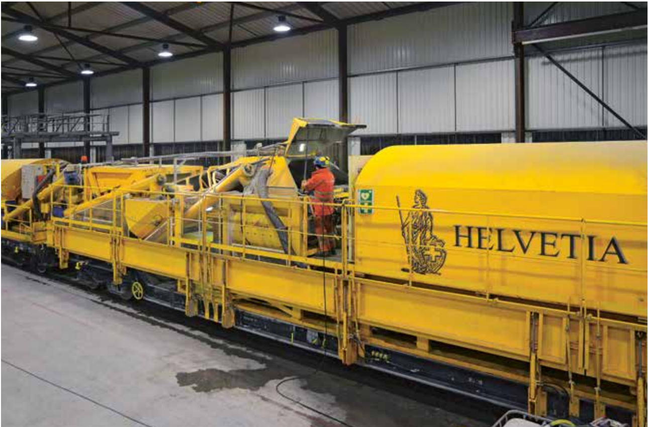
Abbildung 16: Der Betonzug in der Fahrbahnhalle – Materialumschlagplatz sowie Wartungs- und Instandhaltungswerkstatt ©TTG
